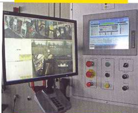
L'installation électrique et de supervision réalisée par Seirel Automatismes à Val Thorens.
